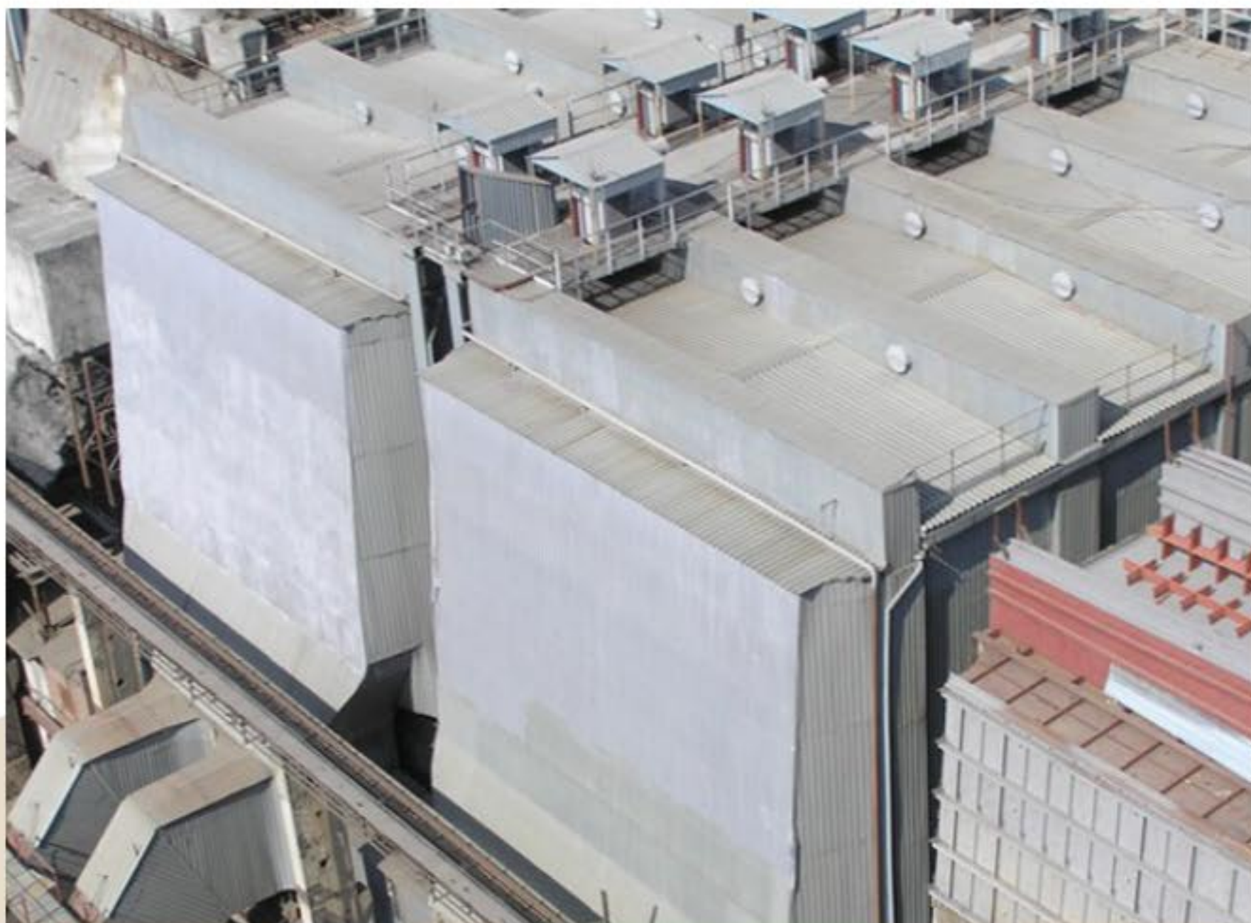
Очистка отходящих газов котлоагрегата ТП-100
